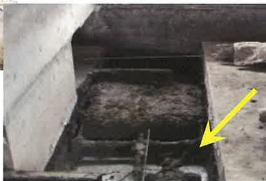
牽引量を超過している状態
