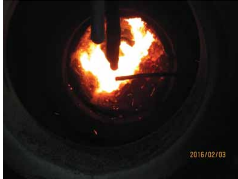
図 1-10 美浦堆肥の燃焼状況 (溶融物が壁面に付着している)
