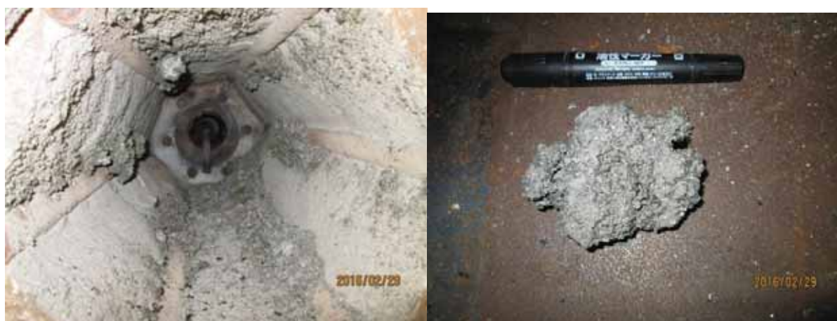
図 1-14 栗東トレーニングセンターのウッドシェーブ混合馬ふん燃料での燃焼灰の溶融状況 左：キルン壁への溶着状況、右：灰だめに落下した溶融灰（溶岩状で硬い）
