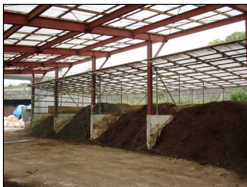
写真5 順調に稼働している堆肥化施設
