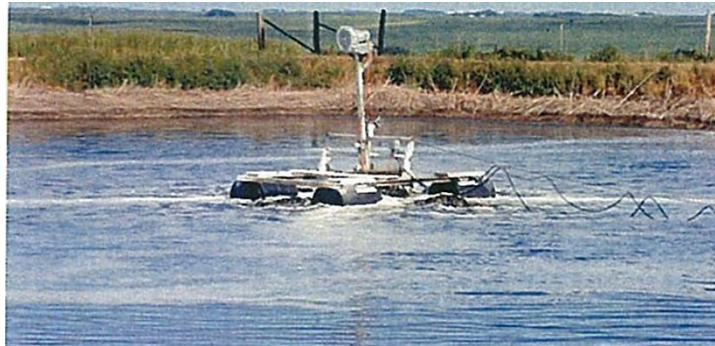
養豚施設の二段式ラグーンのエアレーターは硫化水素の発生を低減するがアンモニアの発生は増加する
