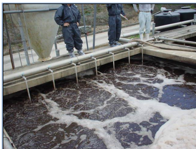
写真6 順調に稼働している浄化槽（活性汚泥処理施設）
