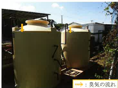
写真 1 臭気捕集タンクの入気側
