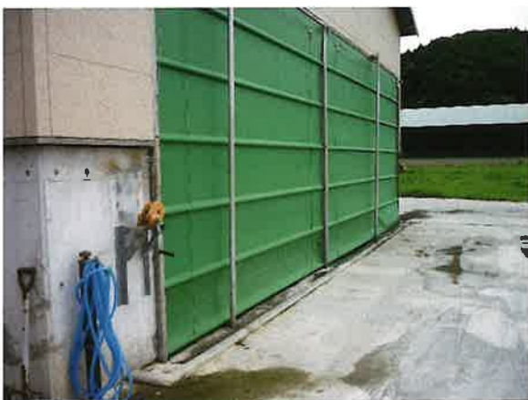
写真 1 脱水機室仕切りカーテン（陰圧）
