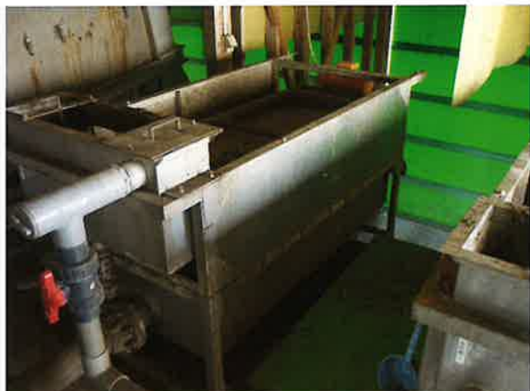
写真 2 脱水機室内部
