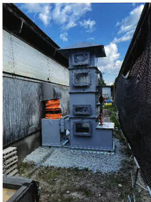
写真1 スクラバー方式による脱臭システム
