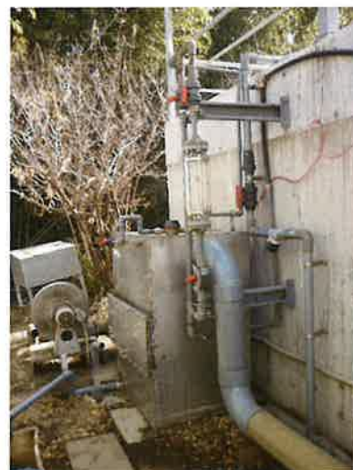
写真 2 水洗脱臭装置
