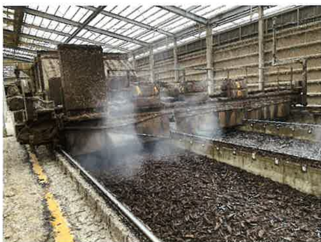
写真1 片側3連の発酵槽と攪拌機
