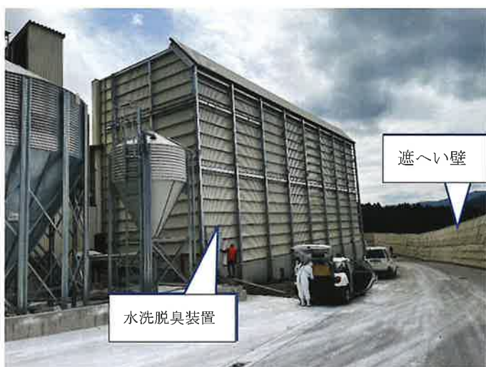
写真3 堆肥舎に併設された水洗脱臭装置
