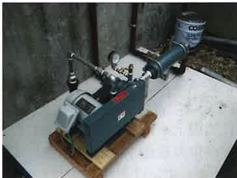
写真 7 脱臭用ブロワ ※1
