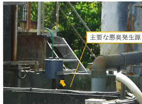
写真 6 原水槽内の吸気口
