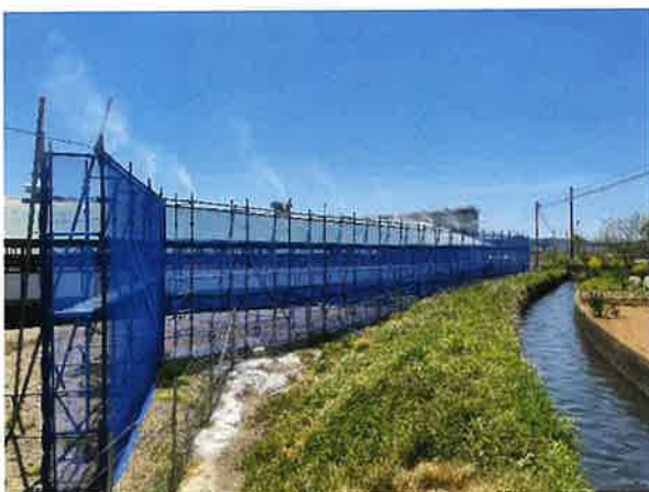
写真 1 遮へい壁+散水システム
