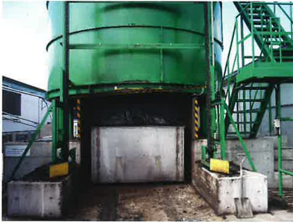
写真3 コンポの堆肥取り出し口
