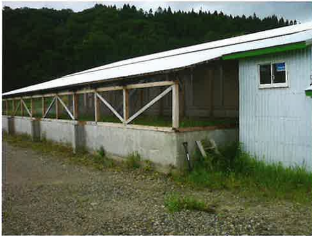
写真3 土壌脱臭装置
