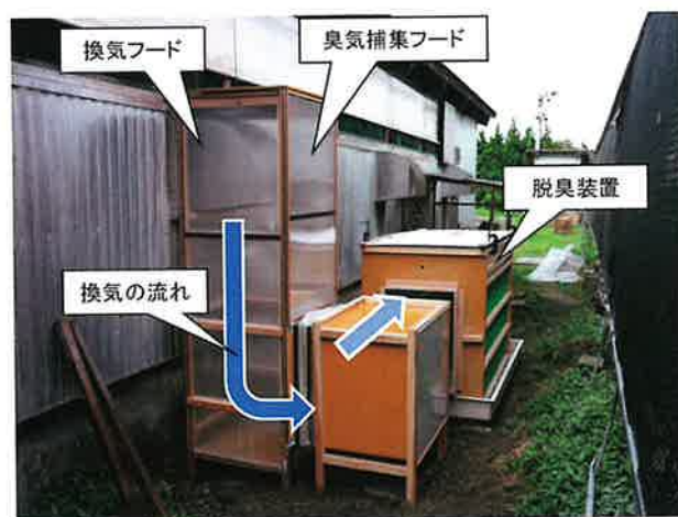
図2 豚舎に設置した概要 (脱臭槽面積：1.8m X 0.9m X 2面 = 3.2m 2 )
