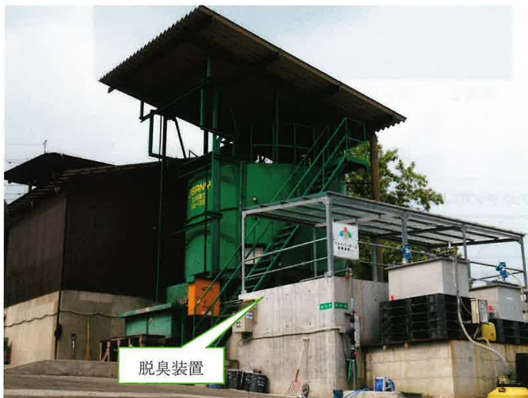
写真 1 密閉縦型堆肥化装置に設置したファイバーボール脱臭装置
