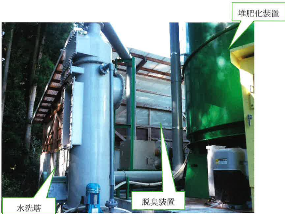
写真 1 堆肥化装置、水洗塔、脱臭装置の配置
