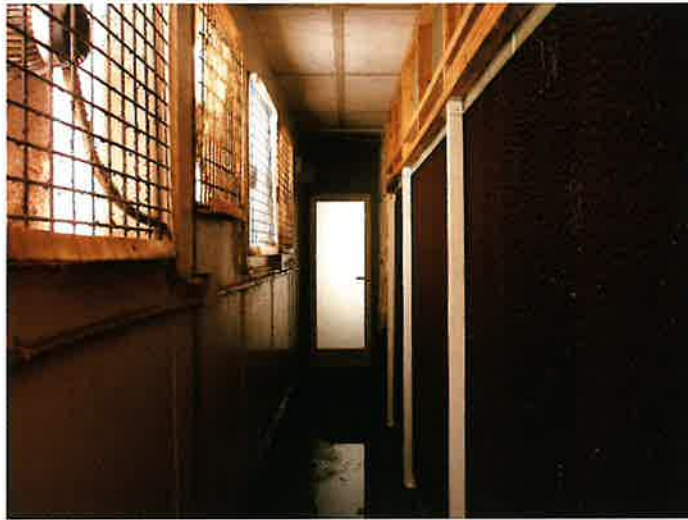
写真2 左に換気扇があり、右に第2フィルターがある
