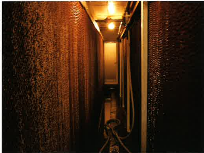
写真3 中央通路を挟んで左側に第2フィルター層、右に第1フィルター層
