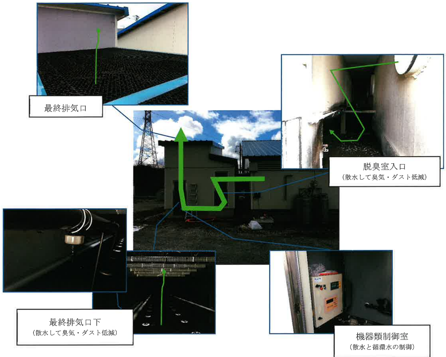
写真2 臭気の流れ（黄色線）と各施設
