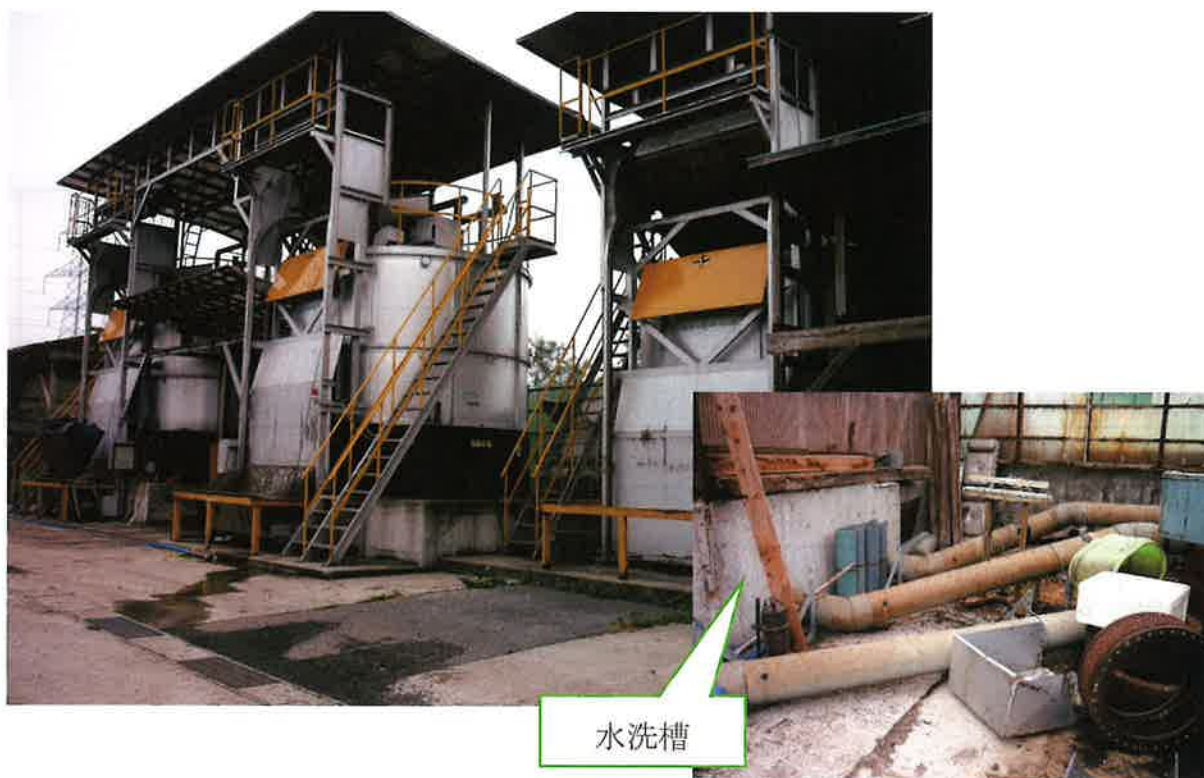
写真 1 3 基の堆肥化装置、各排気ダクトが水洗槽へ繋がっている
