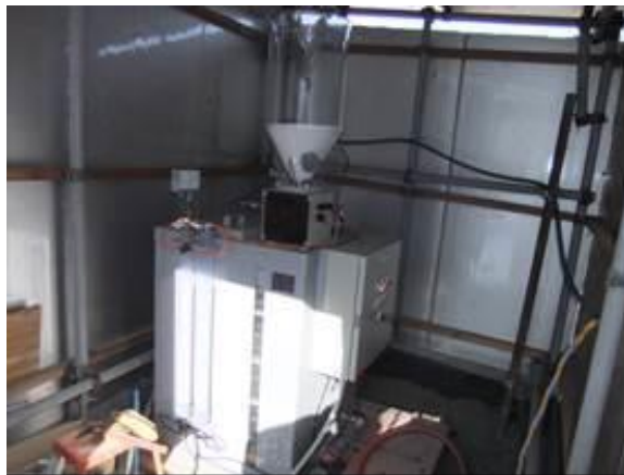
図 128 導入された高分子凝集剤溶解装置
