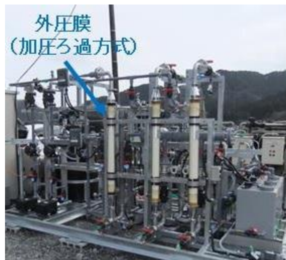
図 170 外圧中空糸膜（加圧ろ過）モジュールの試験状況
