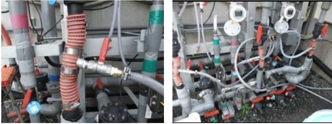
図 124 モジュール下部サクションホースへの合流部
