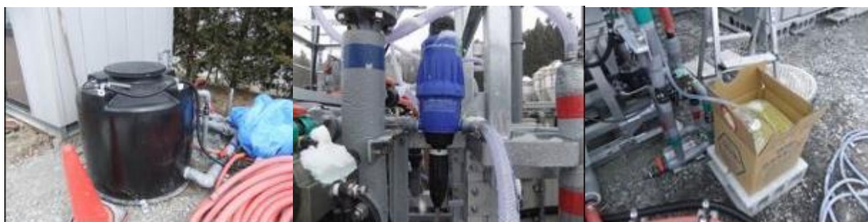
図 105 福島プラントの自動薬液洗浄システム (左：薬液注入用井水貯槽、中央：薬液混合器、右：12%次亜塩素酸ソーダ)
