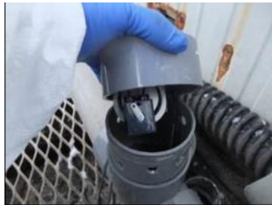
図 185 センサー（防水型照射・受光用ヘッド（IP67））の取付け状況
