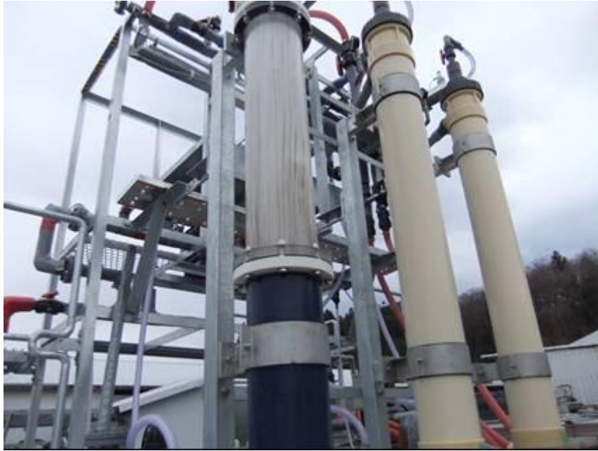
図 34 膜モジュールの設置状況
