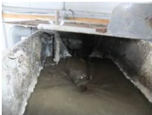
図 189 汚水と凝集剤の合流タンク
