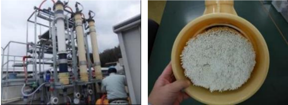
図 106. 設置された中空糸膜モジュールの外観と内部の状況（製作途中）
