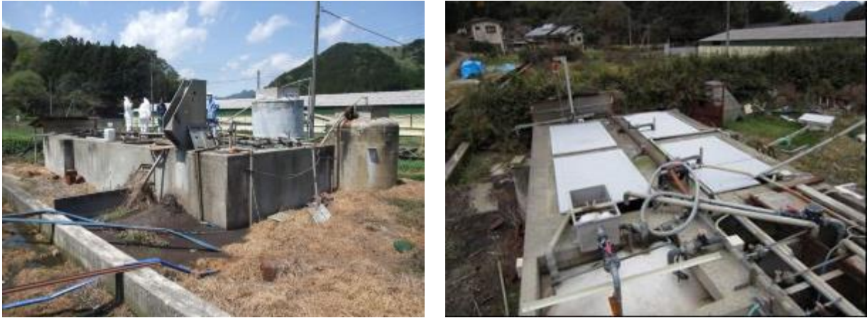
図 80 膜分離装置を設置した浄化施設
