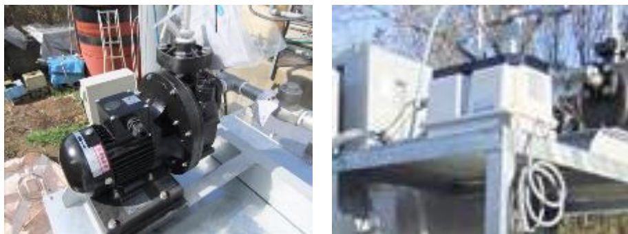
図 65 吸引ポンプ (左) およびブロワ (右)
