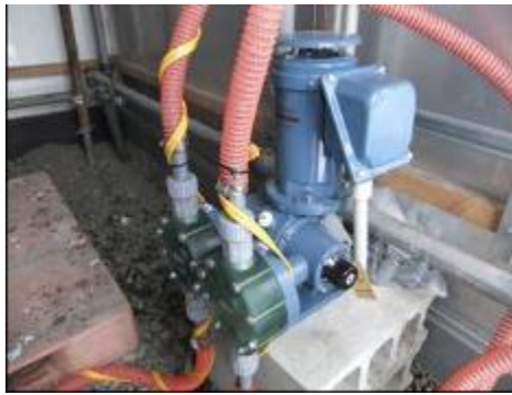
図 188 自動制御中の凝集剤注入ポンプ
