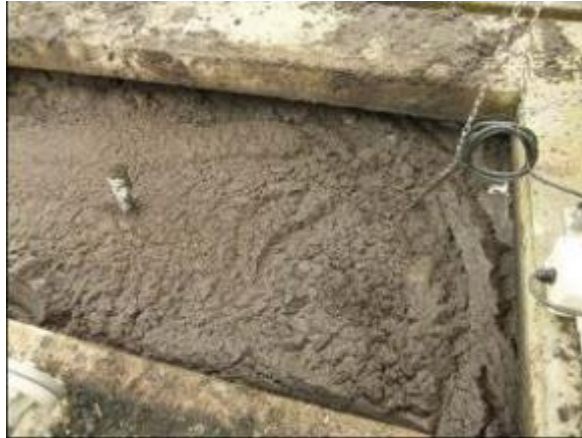
図 40 脱窒槽に蓄積したスカムの状況
