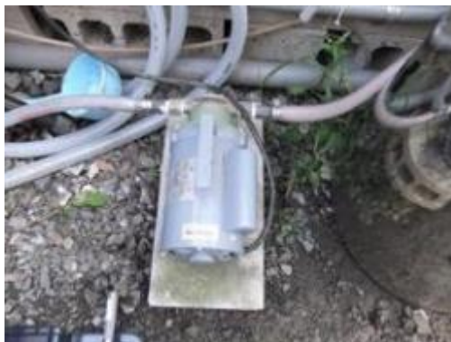
図 122 苛性ソーダ溶液注入用ポンプ（モノフレックスポンプ）
