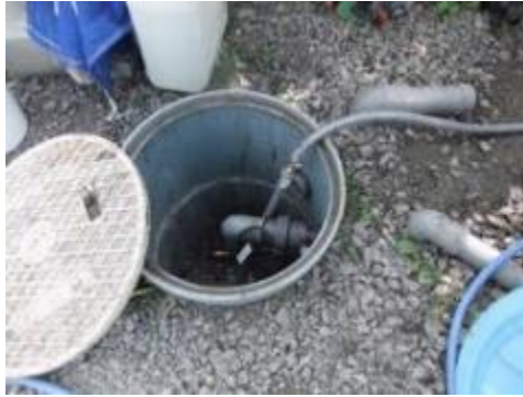
図 120 モジュール内汚水の排出状況
