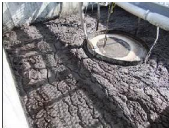
図 1 沈殿槽のスカム蓄積トラブルの事例
