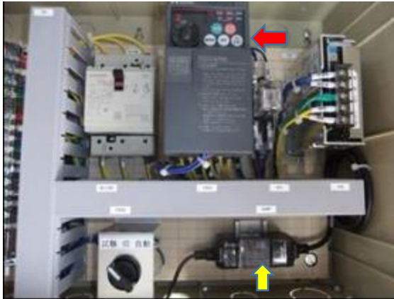
図 187 受光強度出力（4-20 mA）用コントローラ（黄色矢印）と凝集剤注入ポンプ制御用インバーター（赤色矢印）
