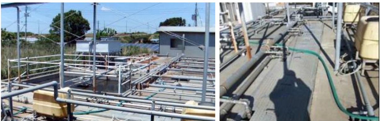
図 62 槽別置き型膜を設置した汚水処理施設（左：全景、右：既設膜浸漬槽）
