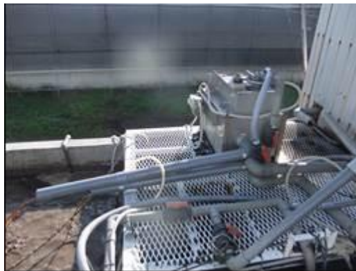
図 116 曝気槽内豚毛除去用スクリーンの稼働状況
