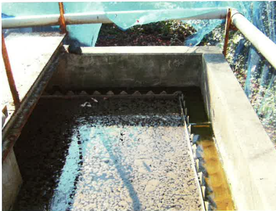
汚泥の浮いた沈殿槽
