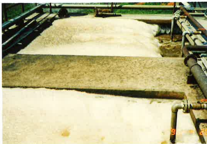
泡が溢れているばっ気槽
