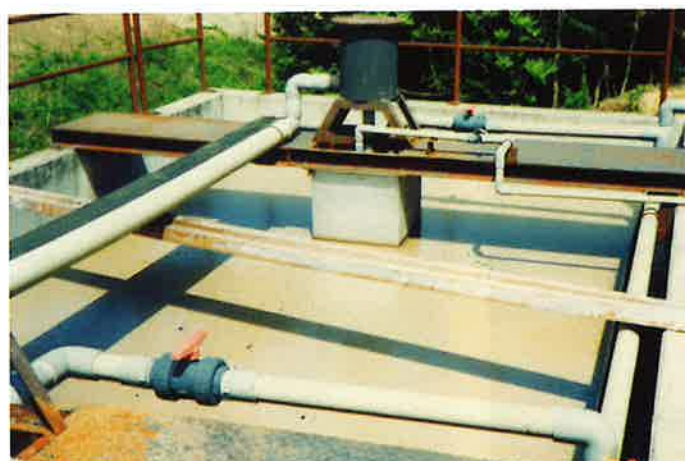
ばっ気槽からの泡で水面が 覆われている沈殿槽
