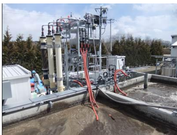
膜分離装置全景
