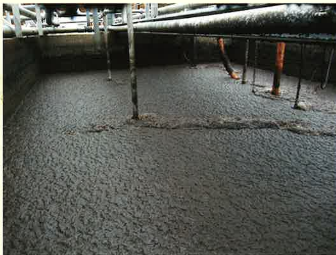
改修後の脱窒工程で第1ばっ気槽に発生した窒素ガスで汚泥が浮上している様子
