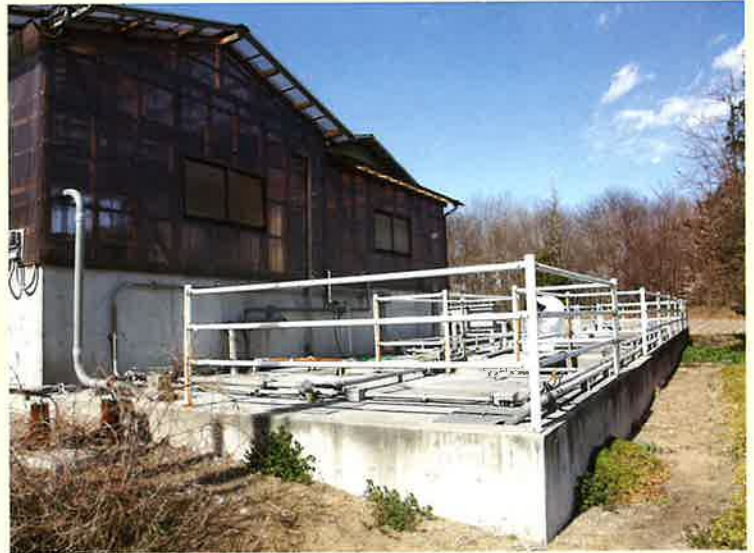
実証試験を行った污水浄化処理施設
