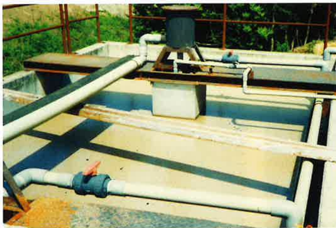
曝気槽からの泡で水面が覆われている沈殿槽
