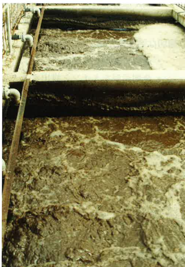
よい状態の曝気槽
