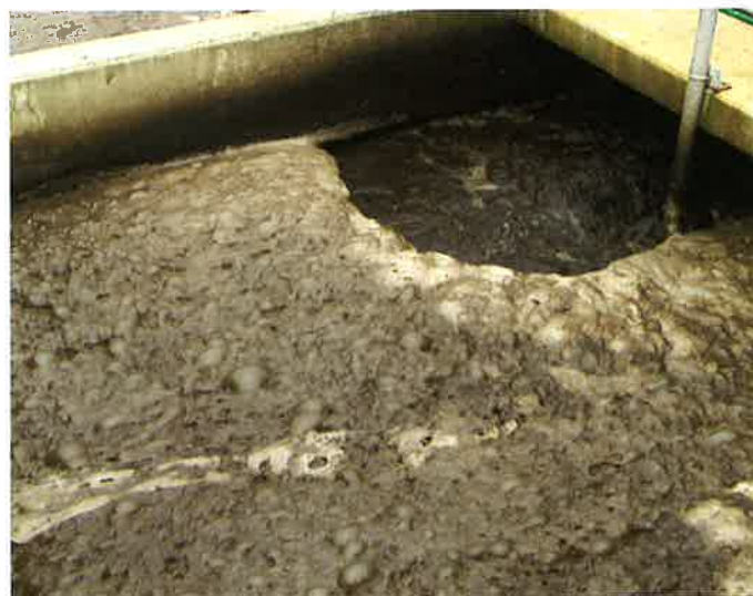
活性汚泥が多すぎることによる曝気槽の発泡
