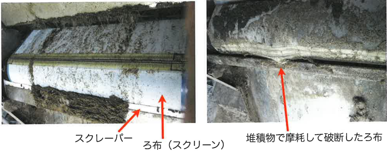
図6-19 ベルトスクリーン型固液分離機のろ布の破断
