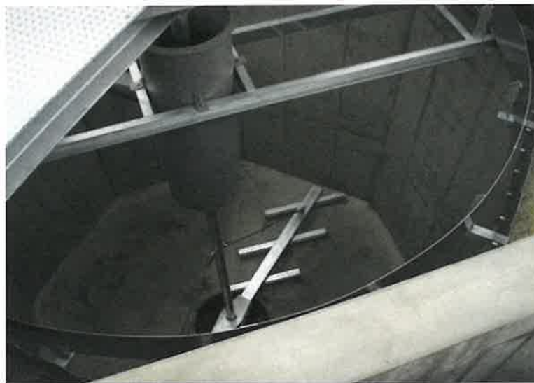
図6-25 沈殿槽の汚泥掻き寄せ機
