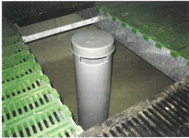
図6-2 オーバーフローパイプ (ピット内の液が一定水位以上になると、上澄み液がパイプの上端付近にある切込み部分から、常時舎外へ流れ出る)
